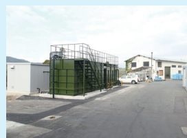
食品事業系排水 ( ジャム製造工場 ) 移設可能施設として本設
