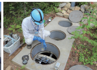
小型合併処理浄化槽の保守点検 (単独浄化槽から最新浄化槽まで)
