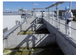
大型工場排水処理施設のメンテナンス
