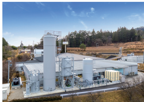
食品工場排水の嫌気処理及び熱利用プラント施設
